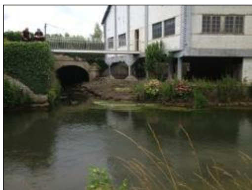
Figure 36 : Point U – Pont partiellement muré
